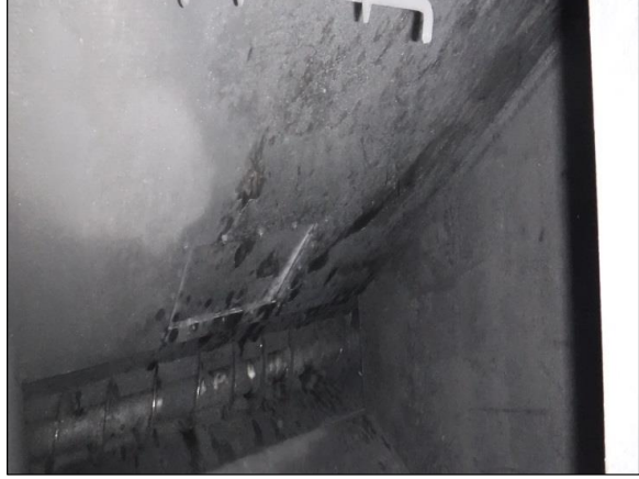
No. 20 灰ホッパ 内部 装置内壁面等付着物有り
