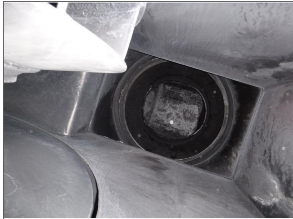
No. 10 煙道 (誘引ファン) ファン内部 ファン出口(上部)
