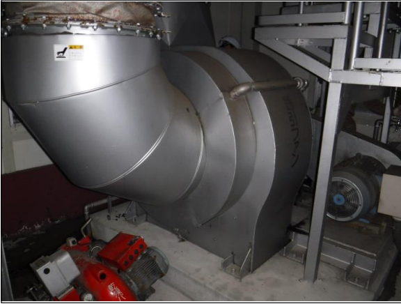
No. 7 煙道 (誘引ファン) 外観
