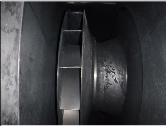
No. 9 煙道 (誘引ファン) ファン内部 インペラ
