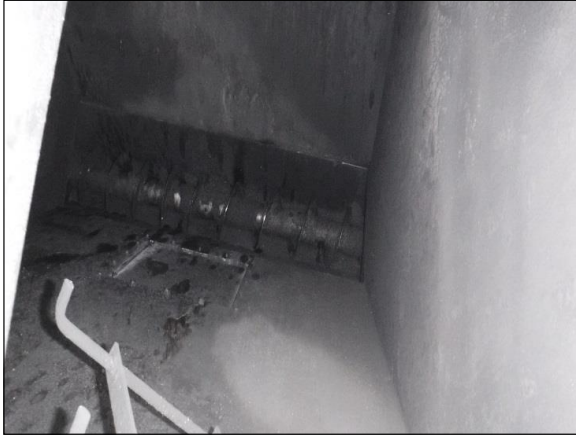
No. 19 灰ホッパ 内部 装置内壁面等付着物有り
