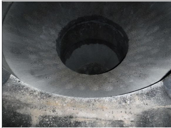
No. 22 その他設備 (熱交換器) 内部 下部 (ガス出口)
