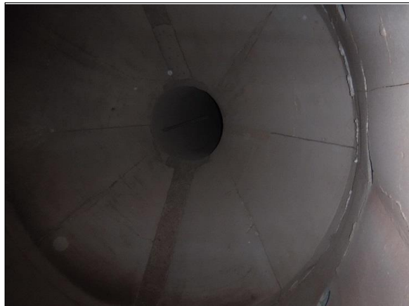
No. 6 し渣焼却炉 炉内部
