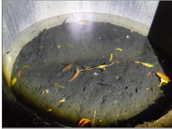
No. 14 煙突 内部 煙突下部 ※堆積物有り
