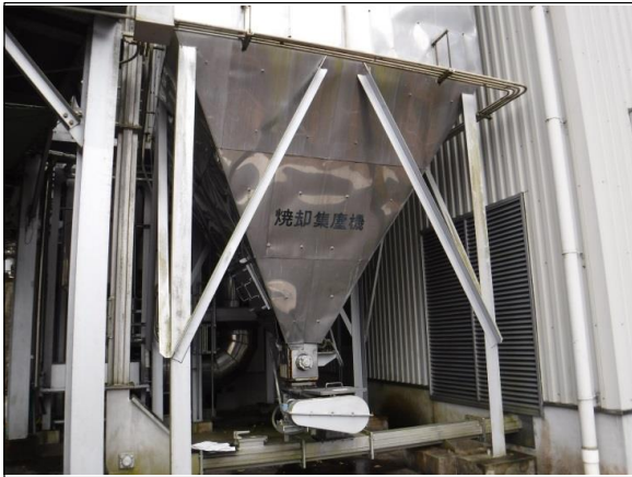
No. 15 焼却集塵機 外観
