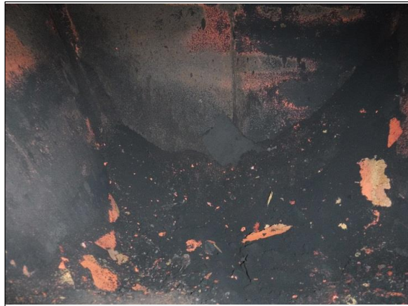
No. 16 焼却集塵機 内部 ホッパ部（集塵機下部） ※堆積物有り
