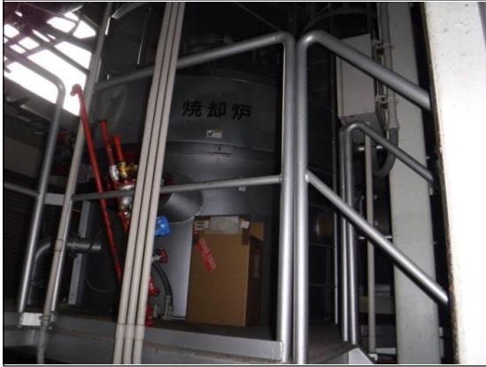
No. 1 し渣焼却炉 外観
